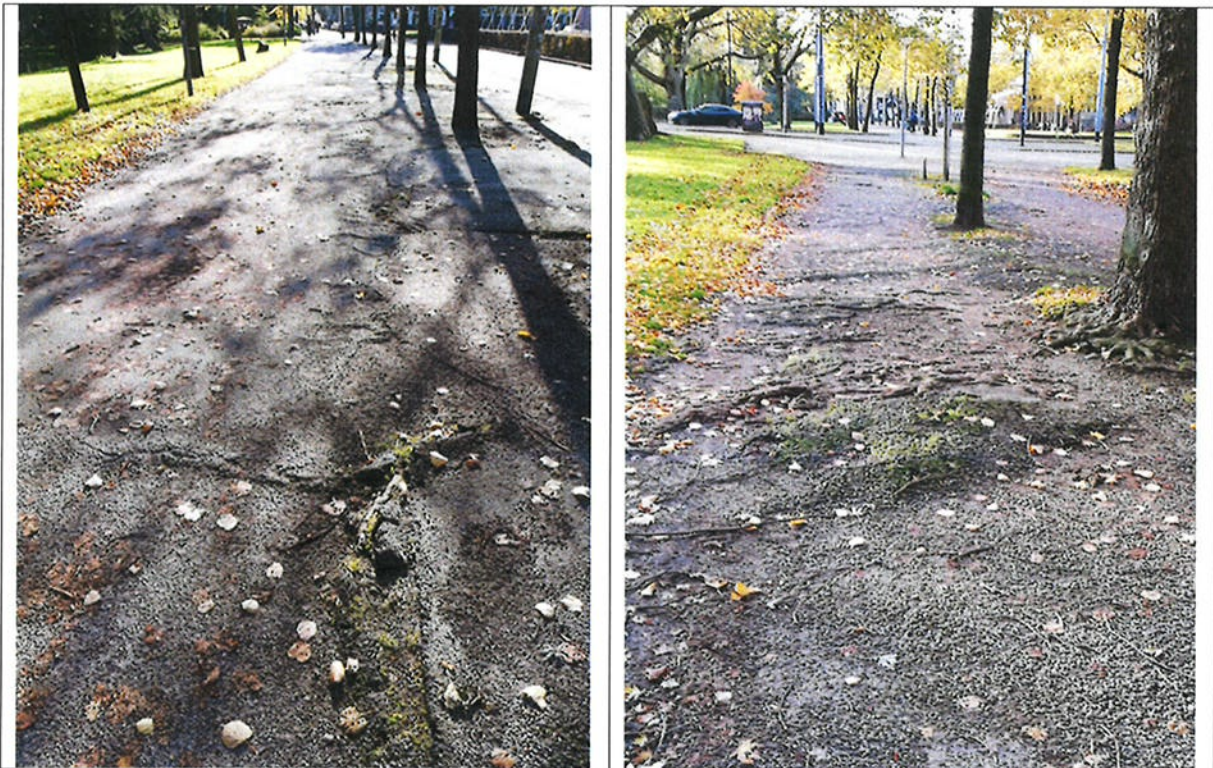
Wandelpad slecht begaanbaar, bedroevend onderhoud, opkomende wortels, bodemverzakking
