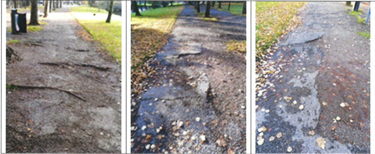
Wandelpad slecht begaanbaar, bedroevend onderhoud, opkomende wortels, bodemverzakking
